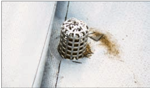
37. mynd. Niðurfall í vegg milli búrs og brúðarhúss. Samskeytin við þakdúkinn eru vandlega soðin saman. Ljós. Guðrún Harðardóttir.
