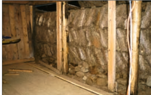
21. mynd. Austurveggur brúðarhúss. Sami halli er á tveimur neðstu lögum klömbruhleðslunnar. Hér má auk þess sjá hvernig járnrenna sem lá yfir veggnum var fest í stoðir og aukastoðir hússins. Ljós. Guðrún Harðardóttir.
