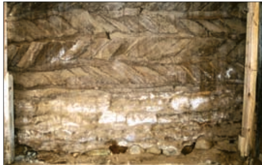
20. mynd. Norðurgafleggur brúðarhúss. Ofan til er övönduð klömbruhleðsla úr þunnum hnausum með miklum halla. Undir henni er kvíahmaushleðsla. Ljós. Guðrún Harðardóttir.
