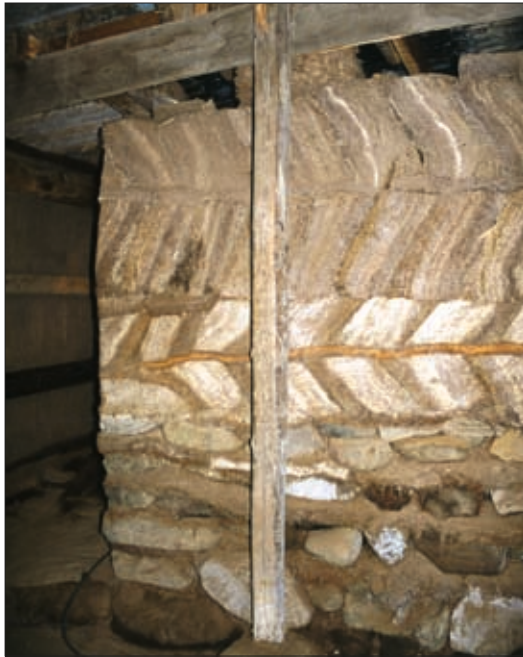
26. mynd. Í göngum. Suðurgafteggur brúðarhúss. Stórgerð klömbruhleðsla, líklega frá viðgerðinni 1976-78, ofan á fíngerðari hleðslu. Ljós. Guðrún Harðardóttir.
